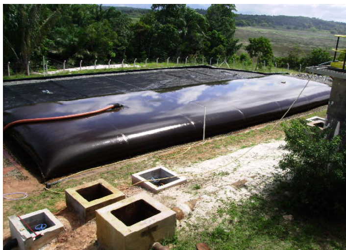
Tecnologia Geotub já está em funcionamento na ETA
